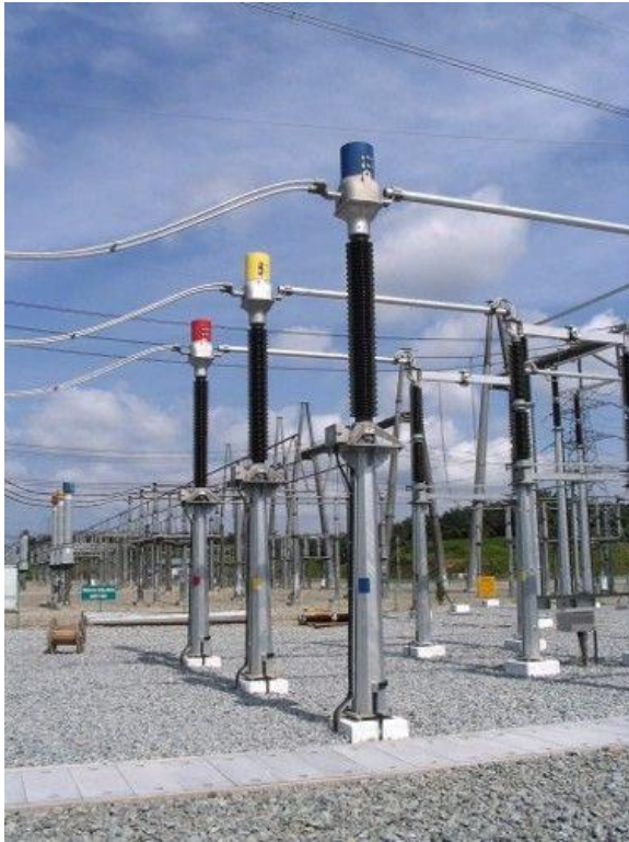
Transformador de corriente
